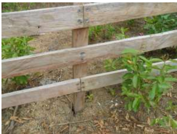
Fallas de calidad estructura corral Foto: Equipo Auditor
