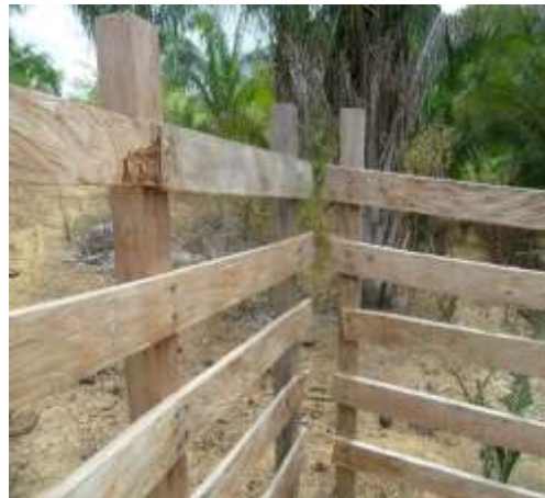
Fallas de calidad Construcción Corral Foto: Equipo Auditor
