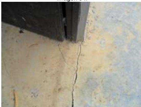
Fallas de calidad piso cocina Fotos: Equipo Auditor
