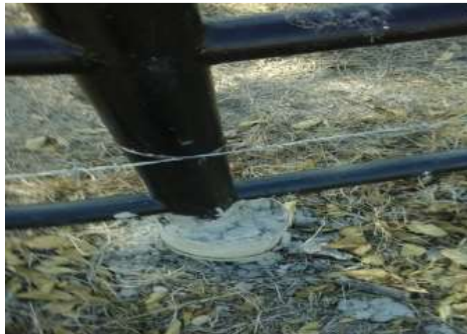
Imagen 35. Estructura corral Debilidad de la estructura
