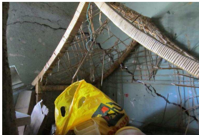
Grieta en vivienda de la vereda Barro Plateado debido a la inestabilidad de la ladera. Fuente: Estudio Amenaza por Movimientos en Masa. SGC. 2015
